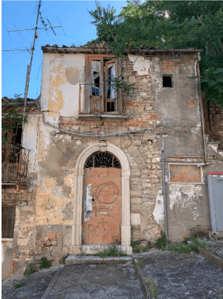
Casa abbandonata sulle Scalelle
